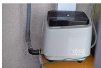
浄化槽のポンプ
